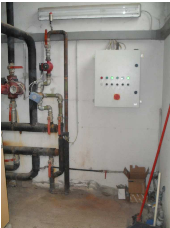
Centrale termica – interno
